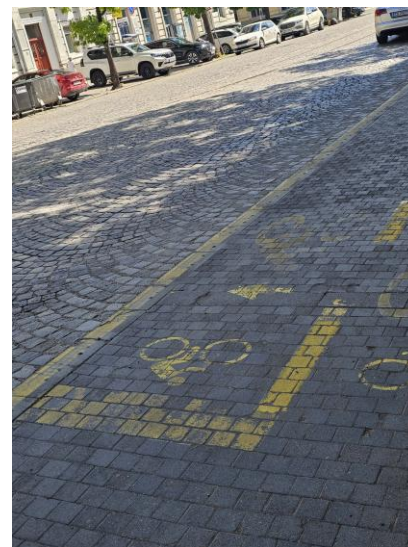
Снимка 3 – Заличена/повредена маркировка на велоалеята
